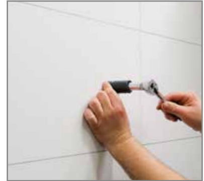
Anschlussstück an der Wand montieren.
